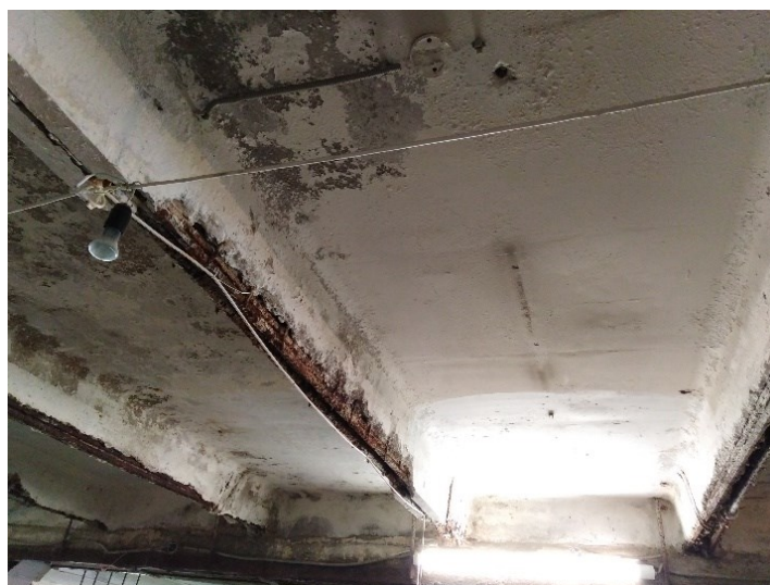
Рис. 1. Ребристые плиты покрытия в транспортном сооружении (Московская область). Срок эксплуатации плит – более 30 лет. Совместное действие карбонизации и хлоридной коррозии. Оголение и коррозия продольной арматуры
